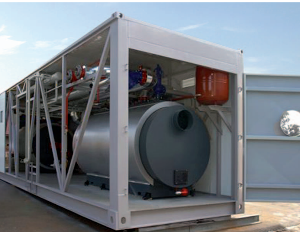
Котельная контейнерного типа (на биомассу)
